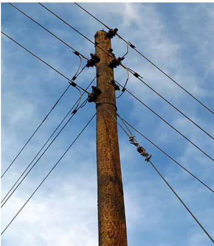
Fig. 41 Luchtlijnen van een lokaal elektriciteitsnet in Oostenrijk.
